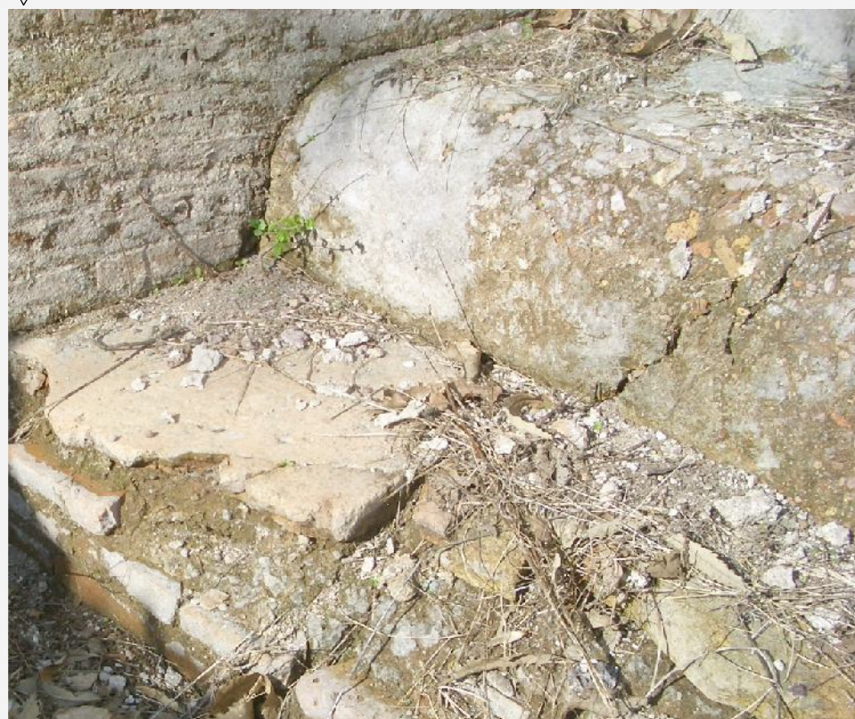
Fessurazioni del cocchiopesto Fessurazioni e fratture dei bipedali
