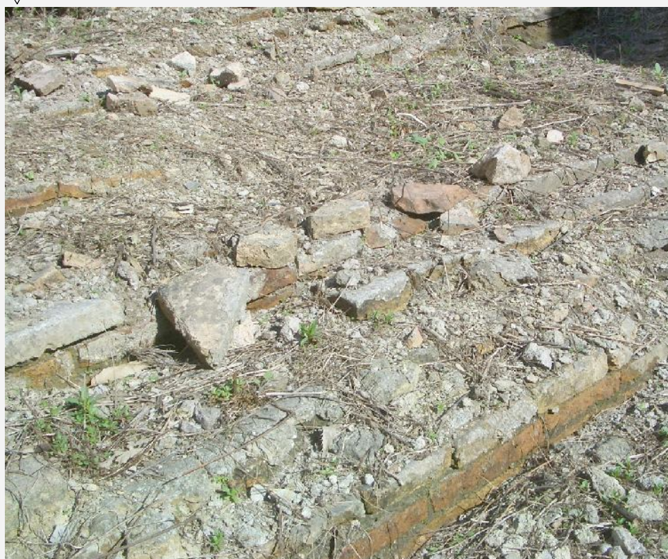
Disgregazione delle malte e distacco dei laterizi
