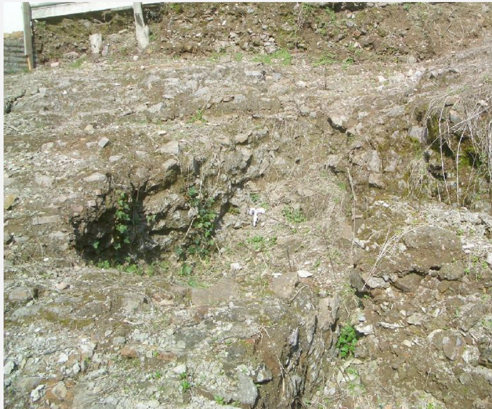
^ Attacco biologico e disgregazione delle malte e dei materiali costitutivi dei nuclei murari
